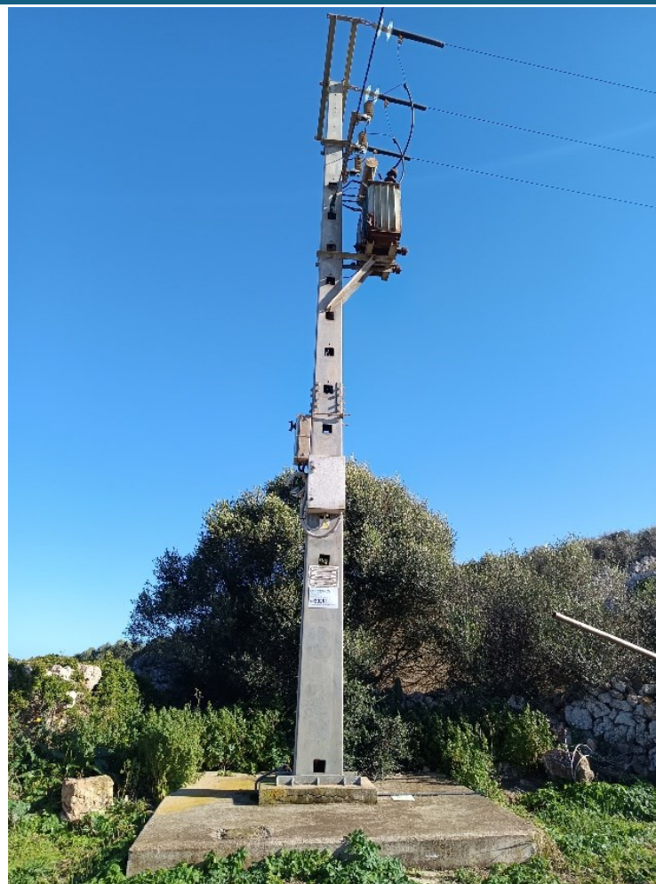
Figura 51. Pal metàl·lic amb cablejat de MT proper al recinte de taula, però invisible des del seu interior.
